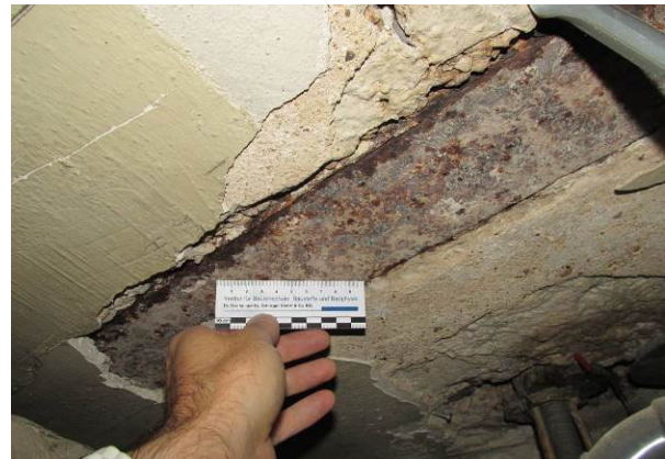
Bild 5: Korrosion eines Stahlträgers der Decke.
