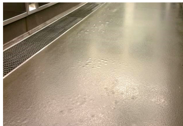
Bild 6: Blasenbildung in der Bodenbeschichtung der Küche.
