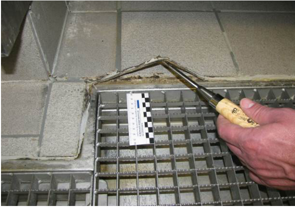
Bild 8: Schadhafte Fugenabdichtung der Anschlussfuge an einer Entwässerungsrinne.
