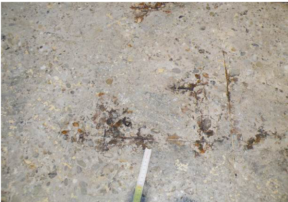
Bild 4: Deckenoberseite nach dem Entfernen des Bodenaufbaus, Korrosion der Bewehrung.
