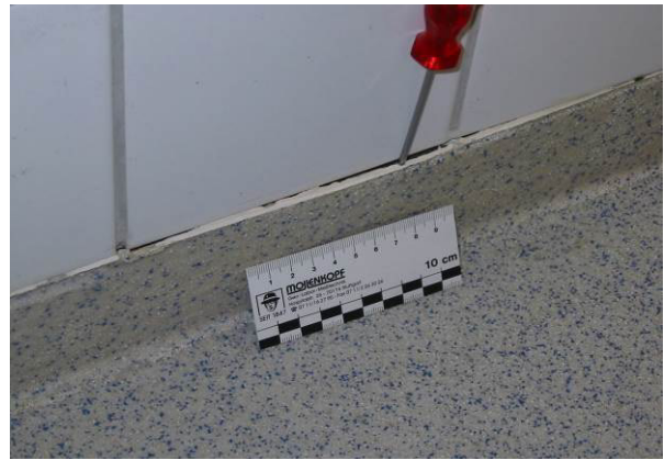
Bild 7: Ablösungen der Beschichtung an den Sockelprofilen.
